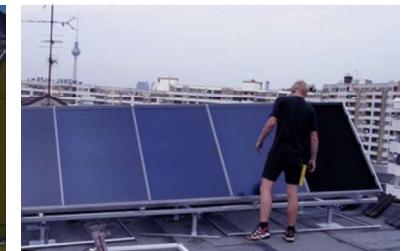
Solar thermal collectors loft Berlin-Kreuzberg
