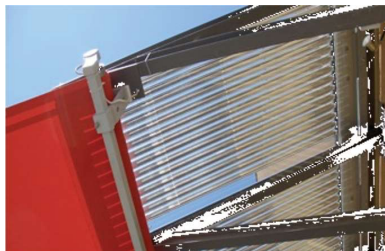
Cafe Bar Brel, Sonnenkollektoren
