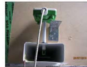
Figure 4: Montaggio anemometro sistema di ventilazione.
