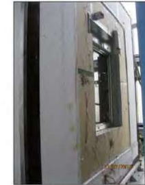
Figure 5: Montaggio sensori lato Fredda.
