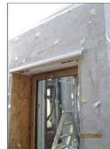
Figure 3: Montaggio sensori lato caldo.
